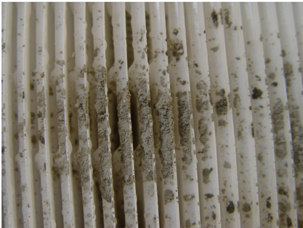
Bild 2: Wärmeübertrager „RS 160“ nach der Anschmutzung, vor der Reinigung
